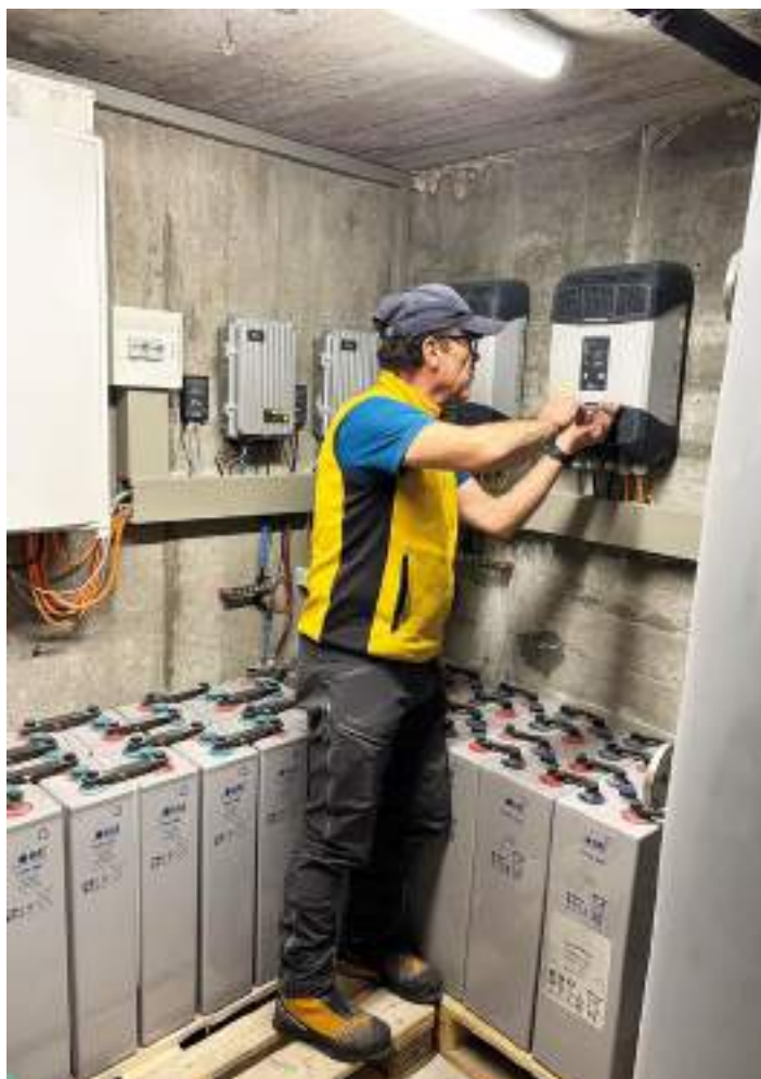
Rico Piazzalunga mentre effettua la manutenzione ordinaria all'impianto fotovoltaico della Capanna Campo Tencia.
