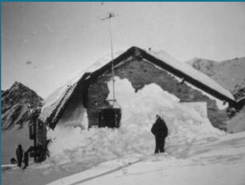
La valanga del 1986 distrugge parzialmente la Capanna Cristallina.
